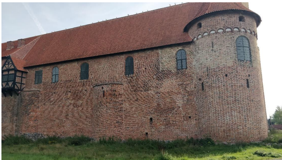
Figur 8-16 Kongefløjen set fra vest. Oprindeligt var bygningen lavere end ringmuren. Ringmuren med flankeringstårne udgør Kongefløjens vestlige facade op til tredje stokværk. Til højre ses det sydvestlige hjørnetårn. COWI.
