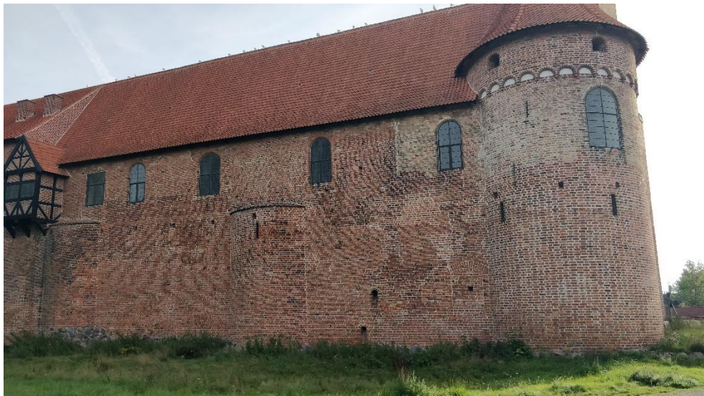
Figur 8-16 Kongefløjen set fra vest. Oprindeligt var bygningen lavere end ringmuren. Ringmuren med flankeringstårne udgør Kongefløjens vestlige facade op til tredje stokværk. Til højre ses det sydvestlige hjørnetårn. COWI.
